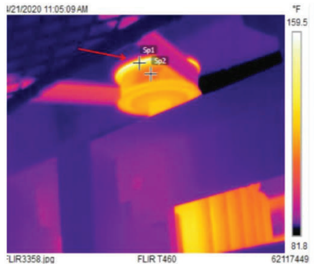
Fin fan pulley thermal profile
